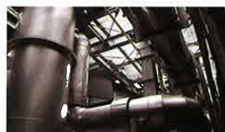
プラント配管
