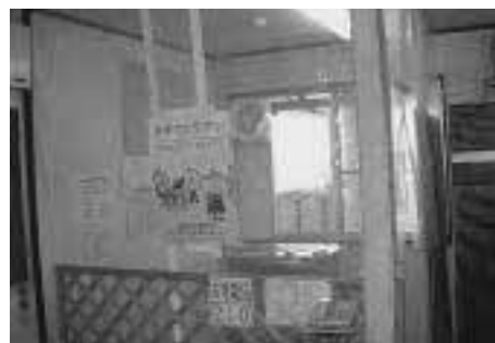
換気扇を付けた分煙ルーム
